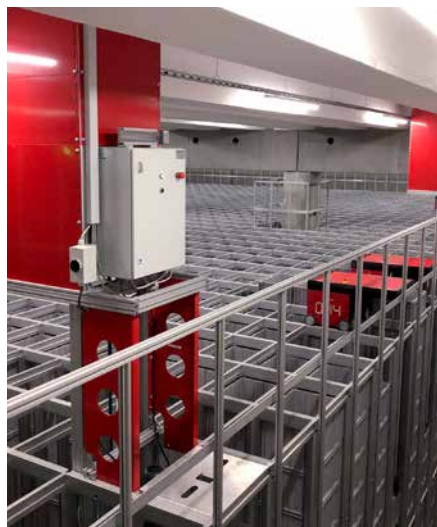
AutoStore kombiniert mit OxyReduct – erste Ebene im Untergeschoss
